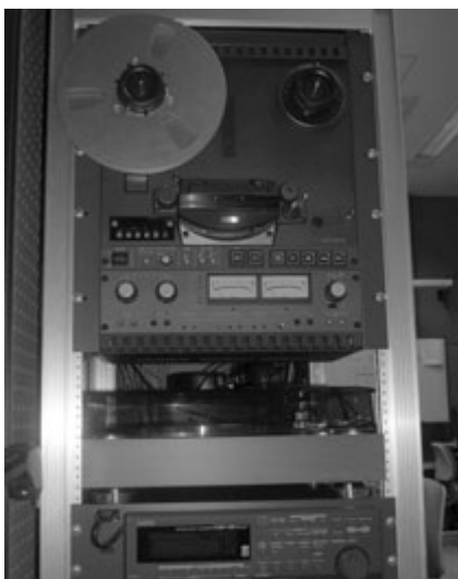
アナログ・オーディオのオープンリールデッキは標準接続に復活。レコードプレーヤは新設された。プレーヤの下は24chハードディスク・レコーダ。
